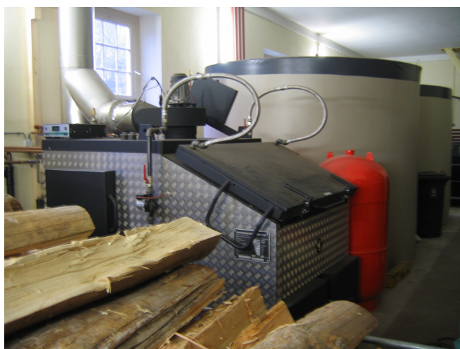
Stukhoutketel (Lopper Drummer 250 kW houtvergasser) Kasteel Wisch, Terborg (foto Martijn Boosten)
